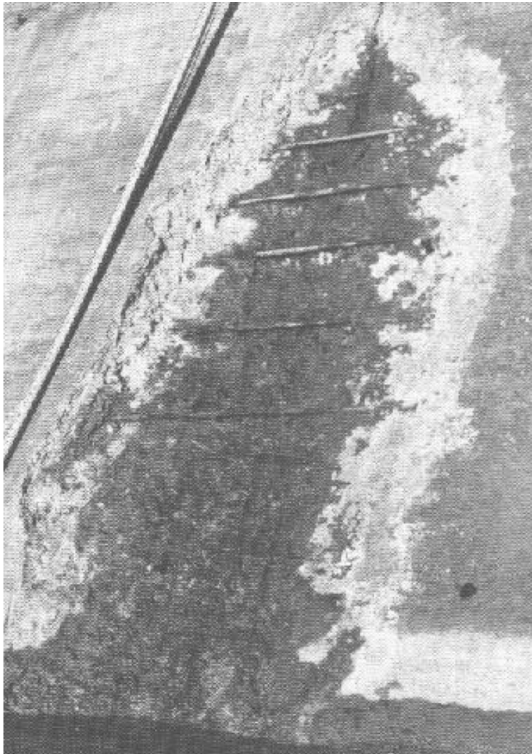
Fig 2.87 - Béton détérioré par une attaque par les sulfates - Barrage Fort Peck sur la rivière Missouri au Montana. [Tiré de MEHTA, P. K. Concrete Structures, Properties and Materials 1986, Prentice Hall, USA, 450 p.]
