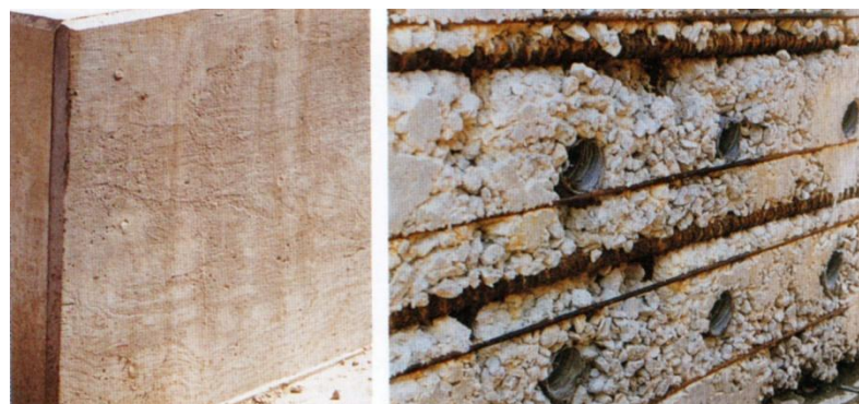
Fig. 6. Une bonne consolidation (à gauche) est nécessaire si l'on veut obtenir un béton dense et durable. Une mauvaise consolidation (à droite) peut entraîner la corrosion précoce de l'acier d'armature et une mauvaise durabilité (dosage et contrôle)
