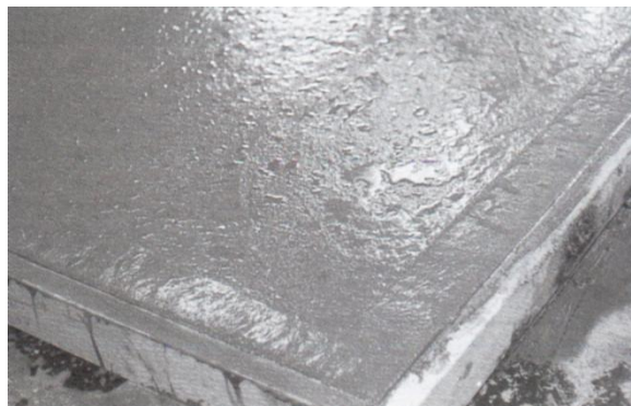
Fig.5 - Eau de ressuage sur la surface d'une dalle de béton fraîchement mise en place (dosage et contrôle)
